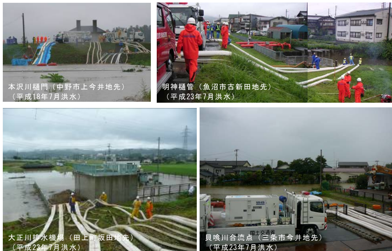
写真 7 内水被害発生と対策の実施状況
