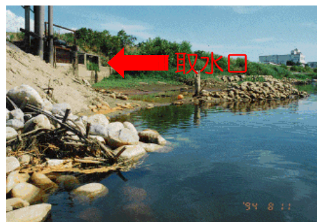
取水口からの取水不能（加茂市）
