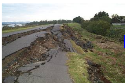
大規模崩壊（長岡市三俣野地先） （平成16年10月24日）
