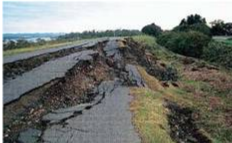
堤防天端の縦断亀裂 (長岡市三俣野)
