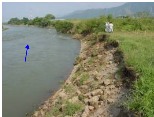
平成 16 年 10 月洪水による河岸の侵食(長野市若穂川田地先)
