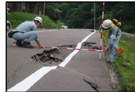
踏査により所管施設の被災状況を調査
