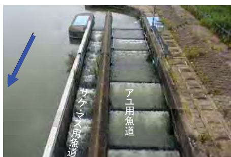
蒲原大堰に設置された魚道
