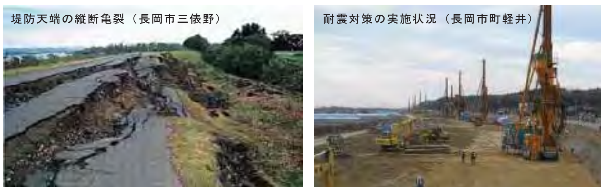
写真 10 新潟県中越地震(左)及び新潟県中越沖地震(右)による堤防の被災状況
