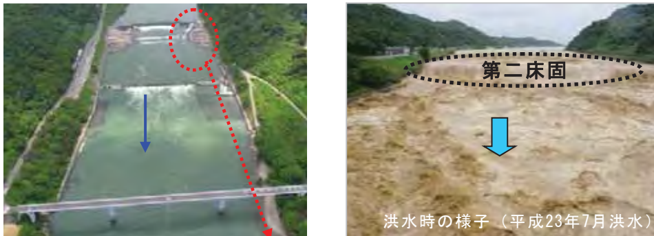
第二床固のひび割れ発生状況 (平成21年調査)
