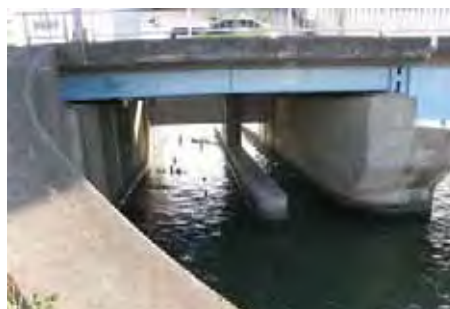
信濃川水門に設置された魚道
