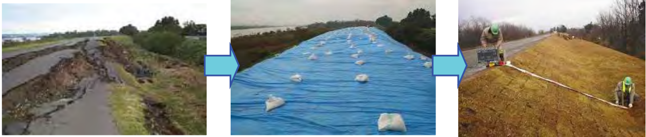
大規模崩壊(長岡市三俣野地先) (平成16年10月24日)
