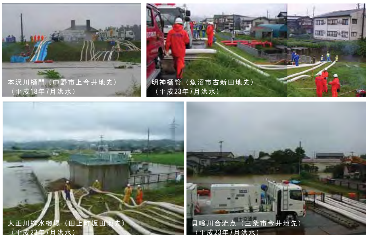
写真 9 内水被害発生と対策の実施状況
