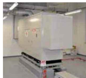
非常用発電設備のイメージ
