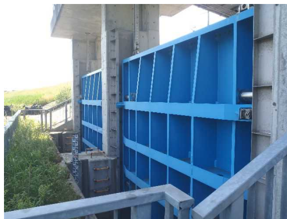
排水樋門稼働状況
