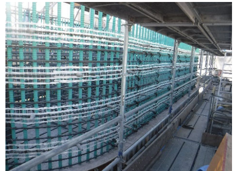
写真-1 ハイパーネット使用状況
