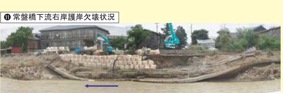
● 7・13新潟豪雨による五十嵐川下流域浸水被害状況 ●
