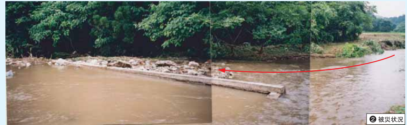
① 被災状況
