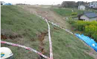
堤防に入った亀裂の確認状況
