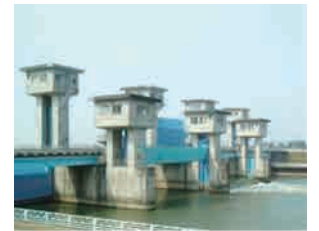
操作頻度の多い中ノロ川水門
