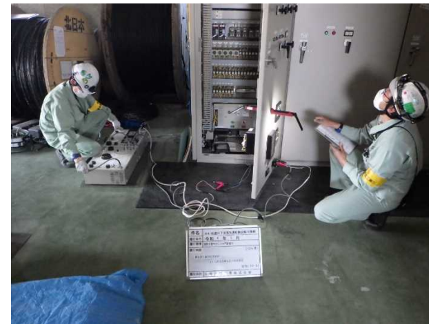
高圧受変電設備
