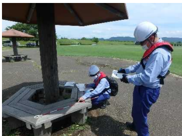
信濃川親水緑地公園 座面の木腐食
