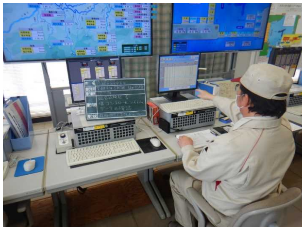
堰管理用制御処理設備
