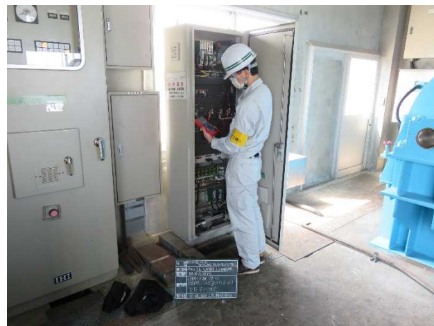
ゲート用機側伝送装置
