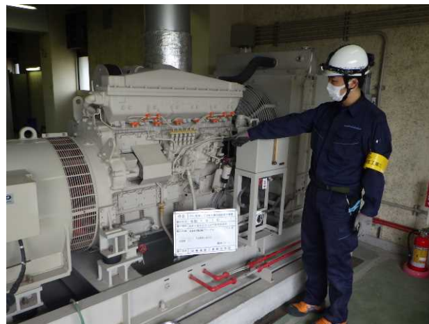
非常用発動発電機
