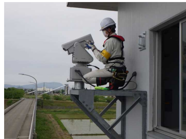
CCTVカメラ設備
