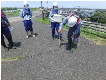
亀鶴橋 クラック
