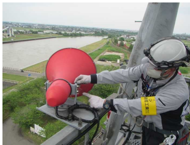
放流警報設備
