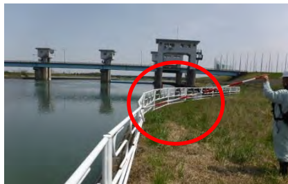
蒲原大堰右岸 転落防止柵曲がり
