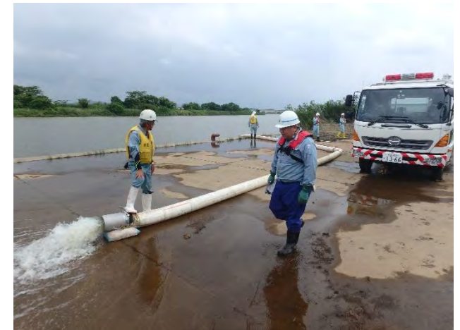
排水ポンプの稼働
