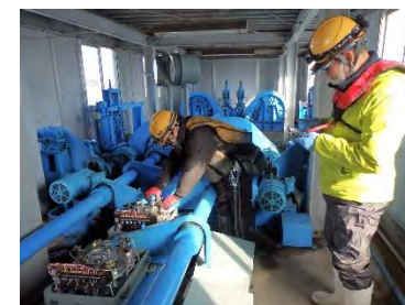
新潟大堰ゲート巻上装置点検
