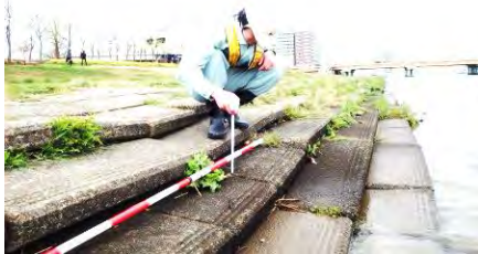
信濃川左岸「やすらぎ堤」 親水護岸ブロック 沈下
