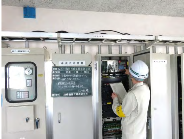
【信濃川水門】 機側伝送装置点検
