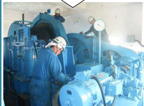
新潟大堰 主ゲート開閉装置点検
