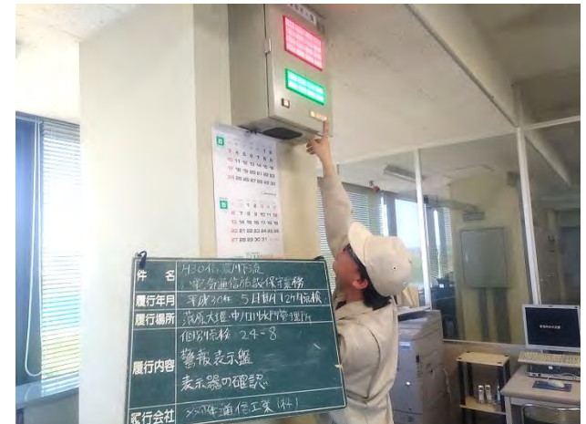
【蒲原大堰・中ノ口川水門管理所】 警報表示板表示器の確認
