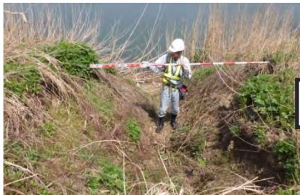
信濃川右岸 河岸土砂崩壊
