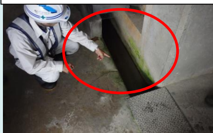
監査廊 排水溝開口部あり(対処前)
