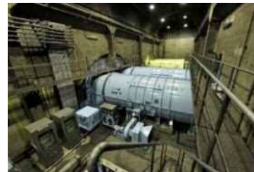
関越トンネル 谷川地下換気所
