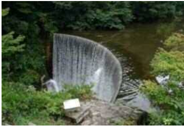
大源太砂防ダム
