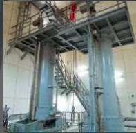
常用洪水吐ゲート室
