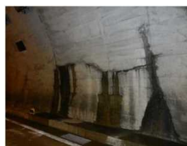
側壁部からの漏水
