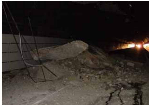
国道17号川口町和南津トンネル コンクリート剥落 (H16.10.24 撮影)
