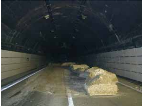
崩落したコンクリート (H16.10.24 撮影)
