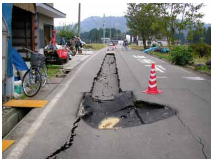
小千谷市木津 下水道の陥没により被災した道路 (H16.10.25 撮影)
