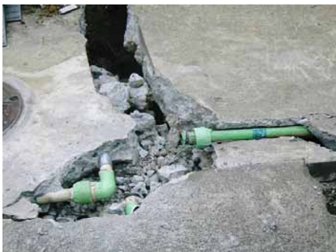
水道管が切断 (H16.10.25 撮影)
