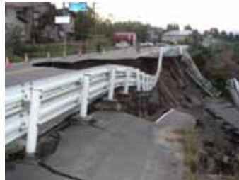
◀ 国道17号 川口町天納 道路崩壊 (H16.10.24 撮影)
