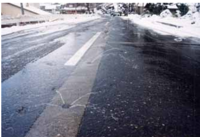
路面の雪を融かす消雪パイプ
