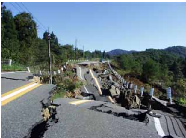
崩壊した一般国道351号(長岡市宮路)
