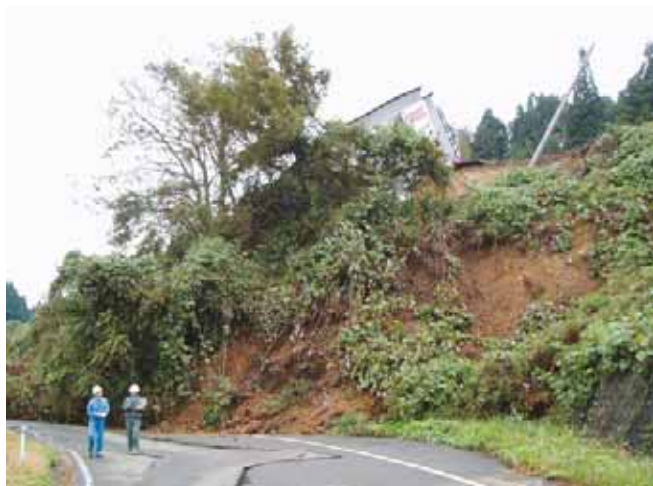
土木研究所による道路斜面調査 【県道 天納川口線 / 川口町牛ヶ島】(H16.10.27撮影) 写真提供: 独立行政法人土木研究所
