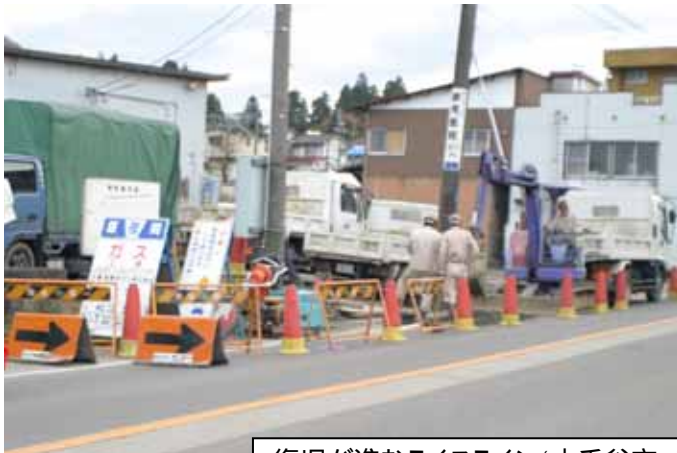
復旧が進むライフライン(小千谷市 H16.11.11撮影) 11月13日には山古志村種芋原地区で電気が復旧
