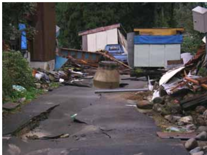
川口町 突き出たマンホール、下水道も寸断 (H16.10.27 撮影)
