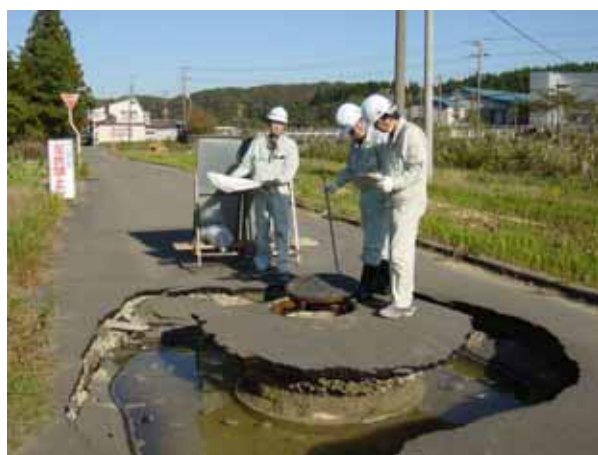
下水道の被災状況把握のための調査(出雲崎町)
