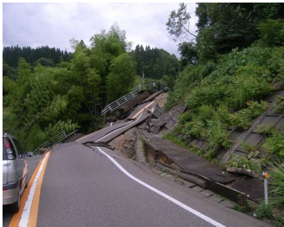
写真1 新潟県中越沖地震による被災状況
