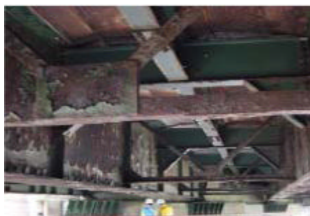
写真4 塩害による損傷状況 (国道8号青海跨線橋 新潟県糸魚川市)
