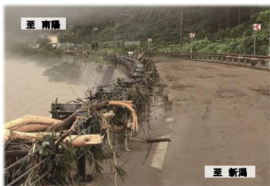
▲令和4年8月豪雨による被災状況
