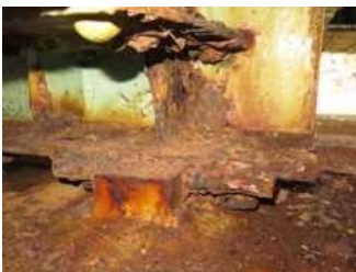
国道8号 石川県 花房跨線橋 (上り) (H27点検健全度Ⅲ判定 桁端部の腐食)
