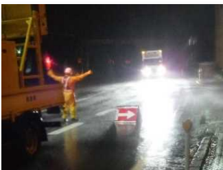
国道17号 新潟県湯沢町 (R1.10 台風19号による通行止め)
