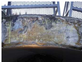
国道49号 新潟県 福取トンネル (H30点検健全度Ⅲ判定 コンクリートの剥離)
