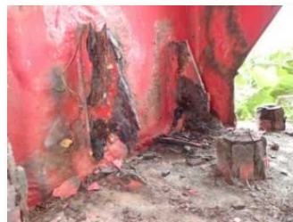
国道41号 富山県 猪谷スノーシェッド (H28点検健全度Ⅲ判定 柱基部の損傷)
