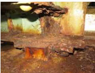
国道8号 石川県 花房跨線橋（上り） (H27点検健全度Ⅲ判定 桁端部の腐食)
