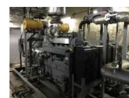
＜自家発電装置＞
