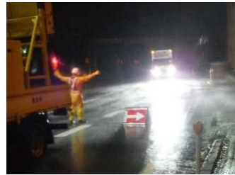
国道17号 新潟県湯沢町 (R1.10 台風19号による通行止め)
