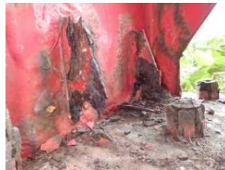
国道41号 富山県 猪谷スノーシェッド (H28点検健全度Ⅲ判定 柱基部の損傷)
