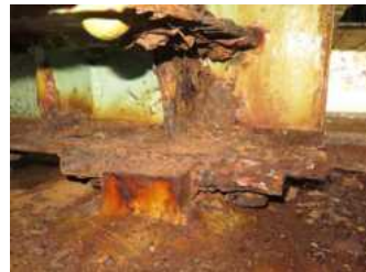
国道8号 石川県 花房跨線橋(上り) (H27点検健全度Ⅲ判定 桁端部の腐食)
