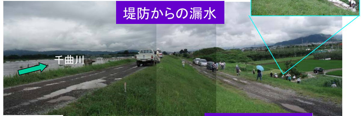
平成18年7月梅雨前線出水 漏水箇所 (千曲川:長野県 須坂市村山地先)
