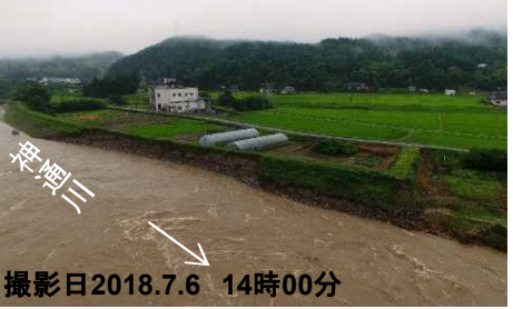
被災状況（被災直後）
