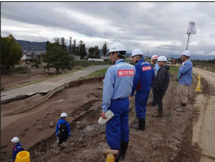
決壊箇所現地調査(千曲川左岸58k付近)
