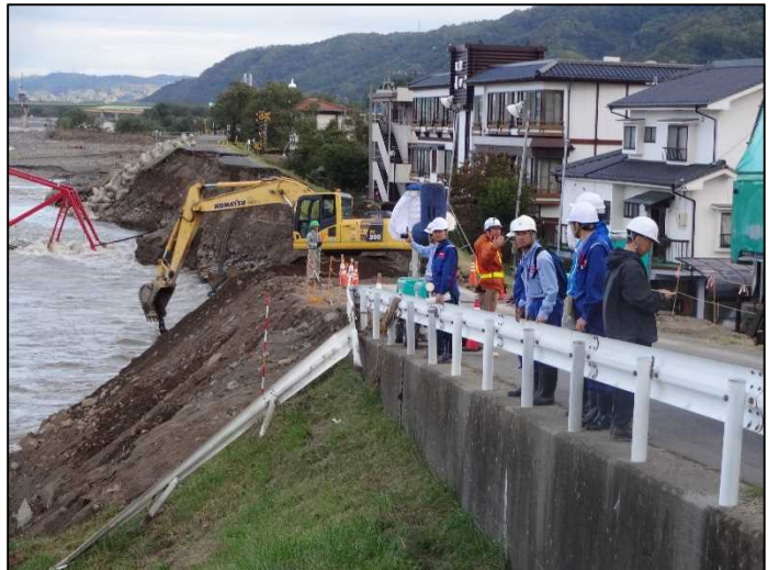
欠損箇所現地調査(千曲川左岸104k付近)
