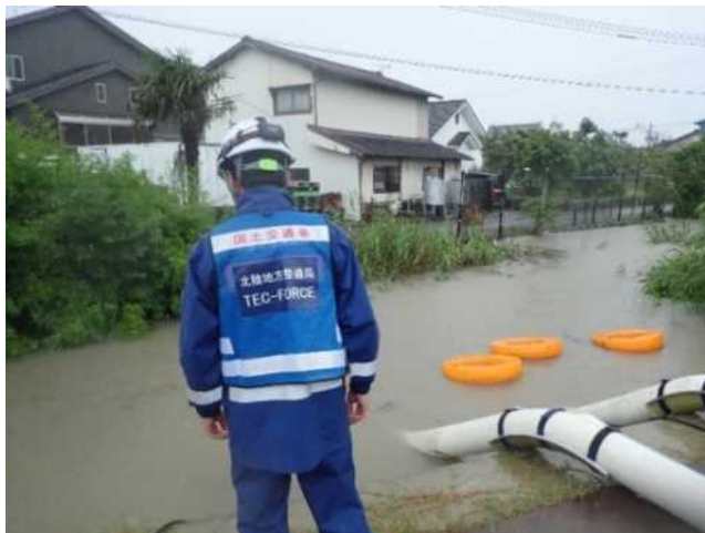
7月9日 筑後川排水作業状況確認 (佐賀県佐賀市) (応急対策班)
