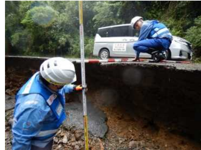
7月9日 村道大川内萩線現地調査 (熊本県球磨郡山江村) (道路班)
