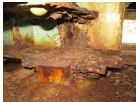
国道8号 石川県 花房跨線橋(上り) (H27点検健全度Ⅲ判定 桁端部の腐食)
