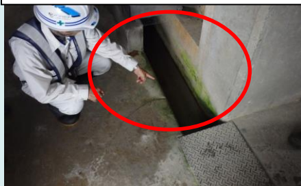
監査廊 排水溝開口部あり(対処前)
