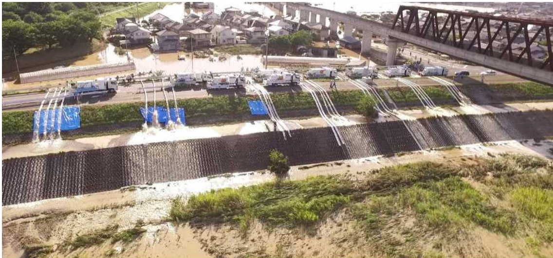
平成30年7月 岡山県倉敷市 台風7号及び前線による出水対応
