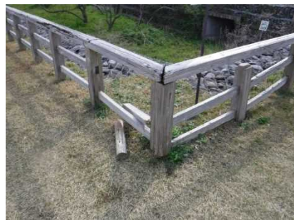
4 月 11 日 木柵破損（手取川）
