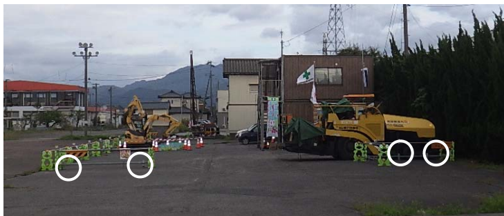
工事現場事務所敷地内バリケード設置状況(阿賀野市安野町)
