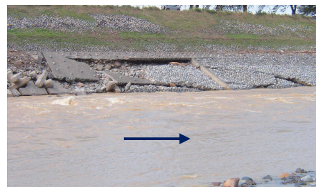
堤防護岸欠壊及び根固流出
