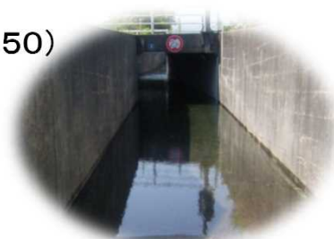
冠水した道路の事例
