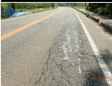
舗装のひび割れ
