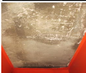
橋の裏面の様子 (床版のひび割れ)
