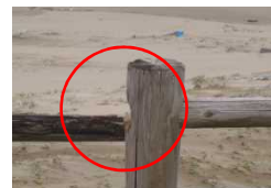
→是正措置完了
