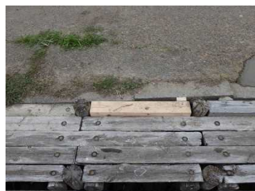
木製踏み板の破損
