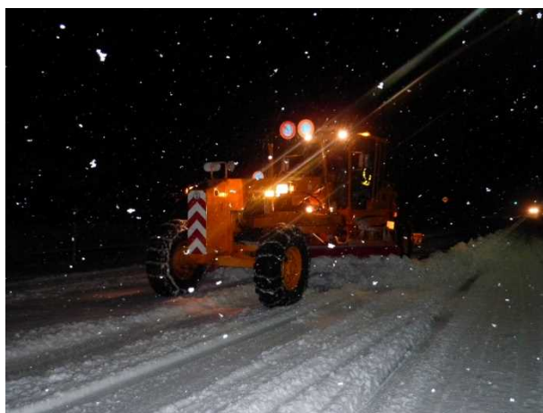
しょうがわまちなや 国道156号砺波市庄川町金屋地先における作業状況
