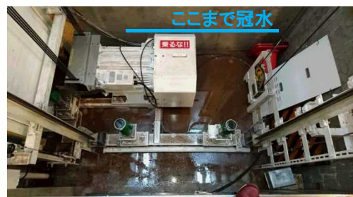
近江町いちば側エレベーターの冠水状況
