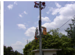
警報装置の点検
