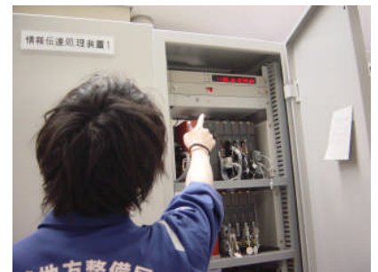
ダム操作機器 の点検
