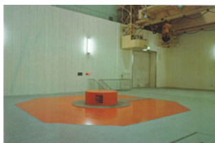
中の沢発電所
