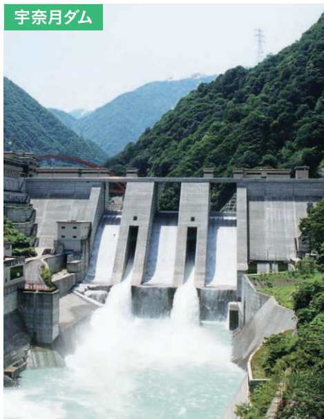
常用洪水吐ゲート
