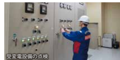
受変電設備の点検
