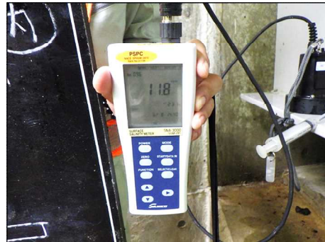
A1側 Mg02桁 下フランジ上面外側 11.8mg/m 2 < 50mg/m 2
