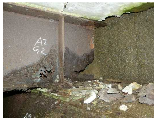
鋼主桁の腐食状況
