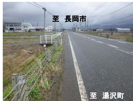
歩道が未整備である
