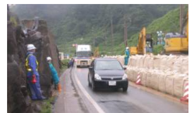
鶴岡市小岩川地内の片側交互通行の実施状況(約8日間実施) H18. 7. 13発生
