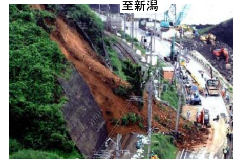
法面崩壊(鶴岡市小岩川地区)
