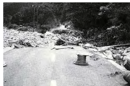
籠川道路の被災状況(S44)
