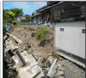
人工斜面崩壊状況(熊本県益城町)
